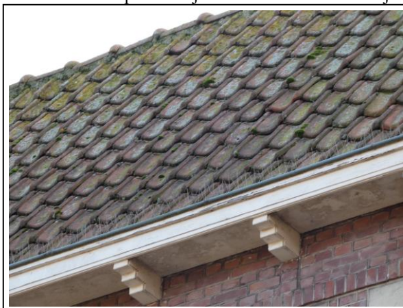
Foto 12 duivenpinnen bij de dakrand aan de zuidzijde
