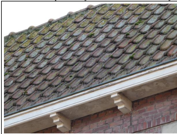
Foto 12 duivenpinnen bij de dakrand aan de zuidzijde
